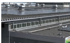
TF-METAL (電洋事業所)
