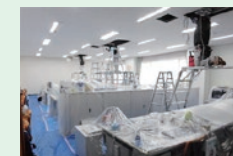
省エネ型空調設備の導入
