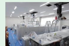
省エネ型空調設備の導入
