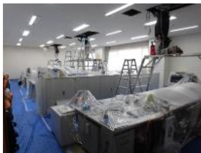
省エネ型空調設備の導入
