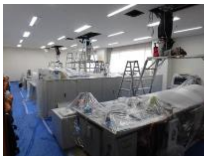
省エネ型空調設備の導入
