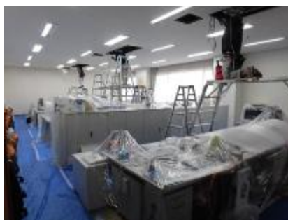
省エネ型空調設備の導入
